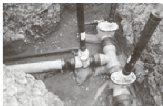
Verzweigung Ischenstrasse. Rechts Hauptleitung, Links Abgang Richtung Ischenstrasse 3c
