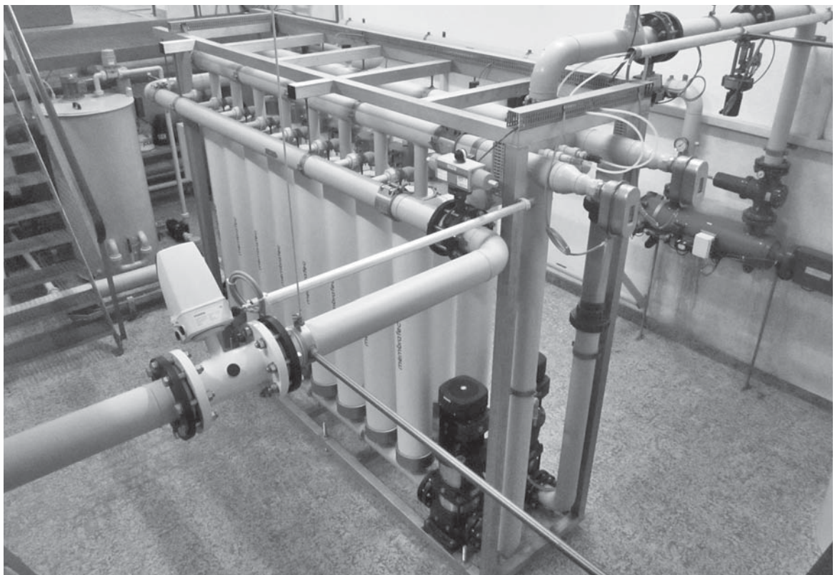
Ultrafiltrationsanlage im Reservoir Gorneren
