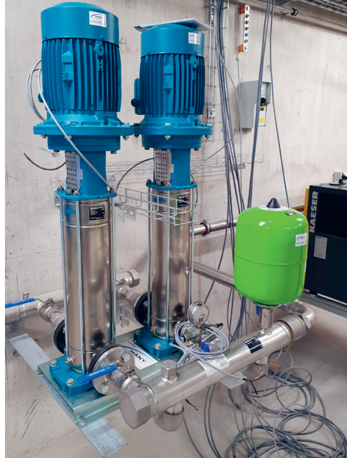
Pumpen Druckerhöhungsanlage Kohltalrank
